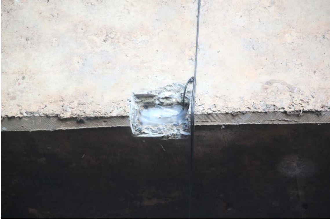
Foto 3 – Sensor de deformação instalado e protegido
