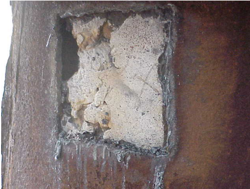
Foto 15 - Essa estaca, localizada na extremidade voltada para o continente, apresentou um ninho de concretagem que possibilitou a colocação de um pedaço de madeira com 32 cm
