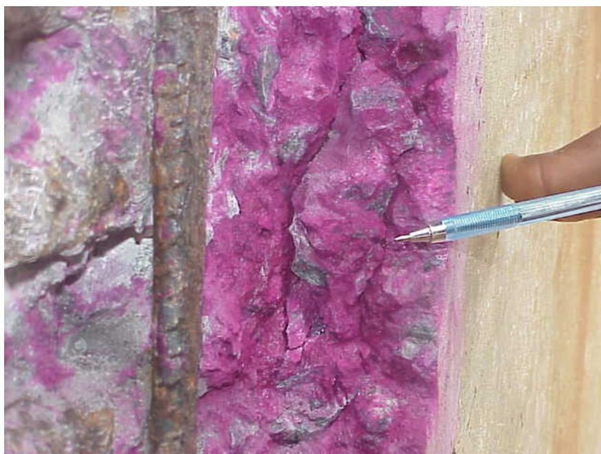
Foto 3 - Após o borrifamento de um indicador (fenolftaleína), observamos o coloramento do perfil do cobrimento
