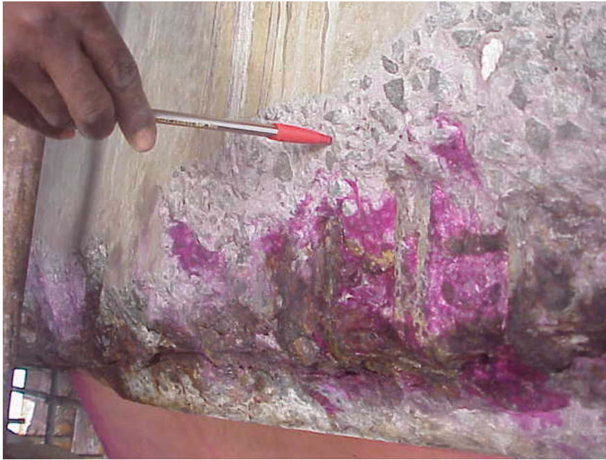
Foto 5 - Perfil com concreto não carbonatado, onde indicado, porém na parte superior da foto, já se vê o início da frente de carbonatação
