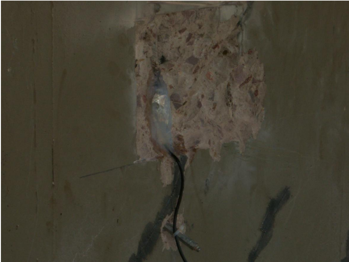
Foto 6 – Sensor “strain gage” instalado e protegido
