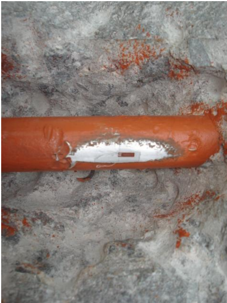
Foto 5 – Sensor instalado na armadura
