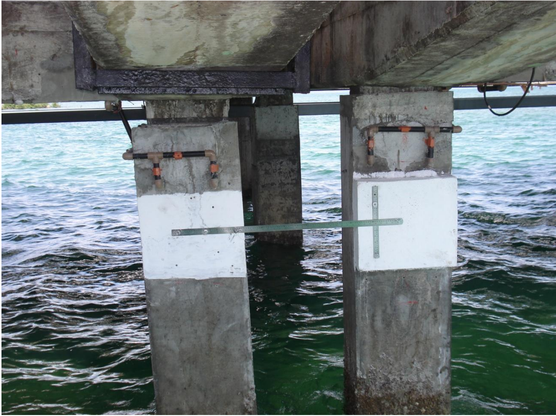
Foto 8 – Detalhe do recalque ocorrido
