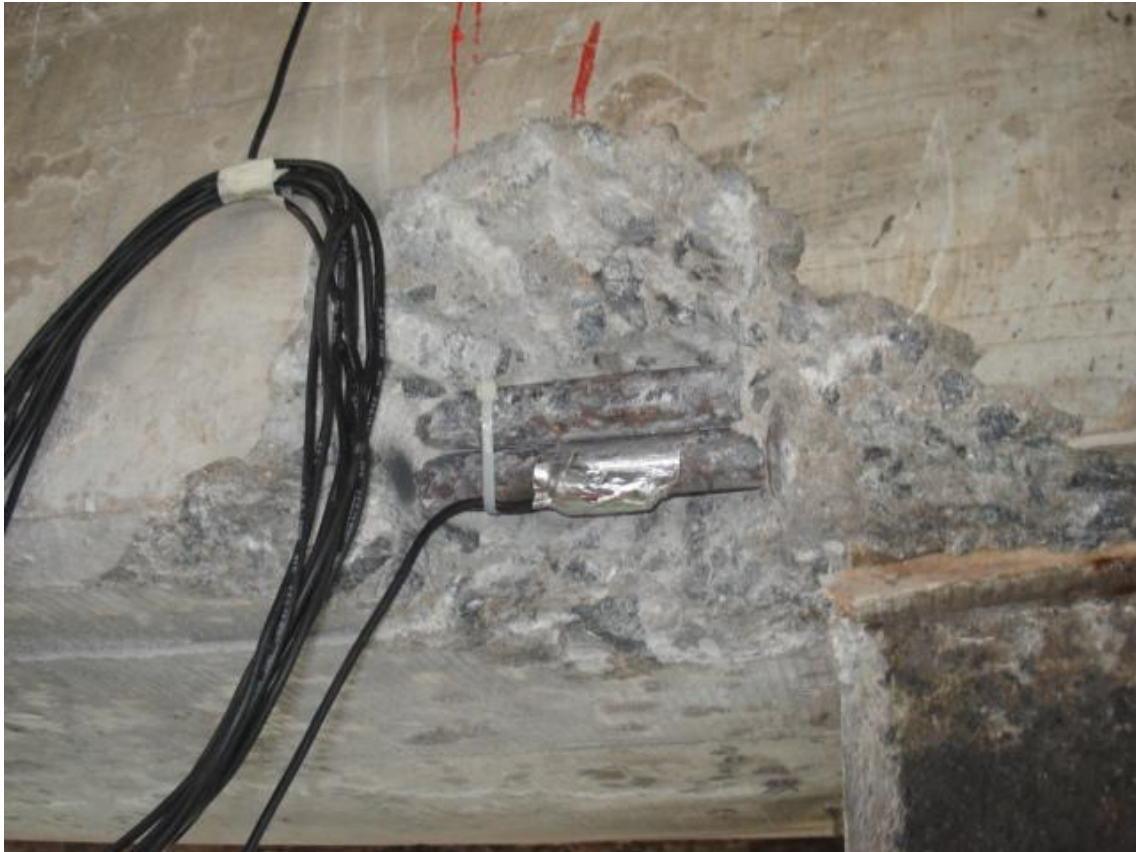
Foto 6 – Sensor protegido com fita metálica (Gaiola de Faraday)
