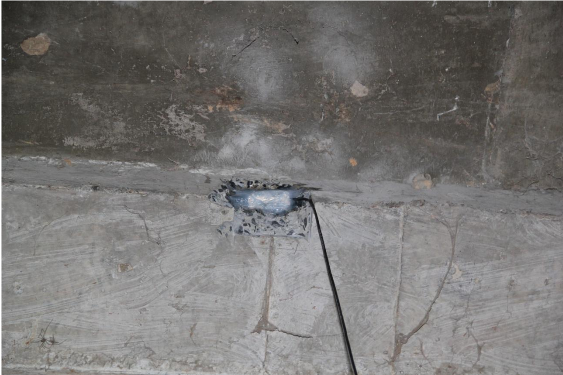
Foto 5 – Detalhe do “strain gage” instalado e protegido
