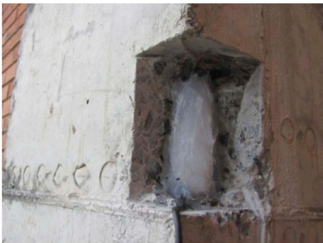
Foto 3 – Sensor de deformação "strain gage" instalado no pilar
