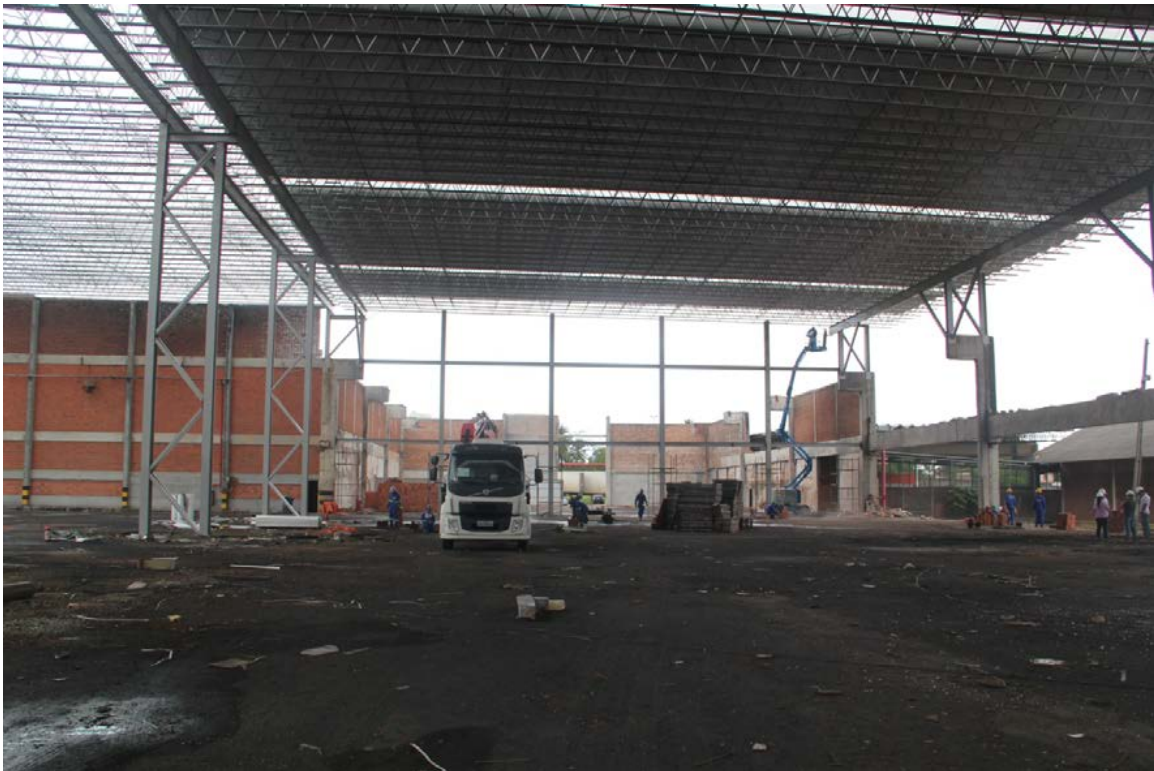
Foto 1 - Vista do Galpão após o incêndio
