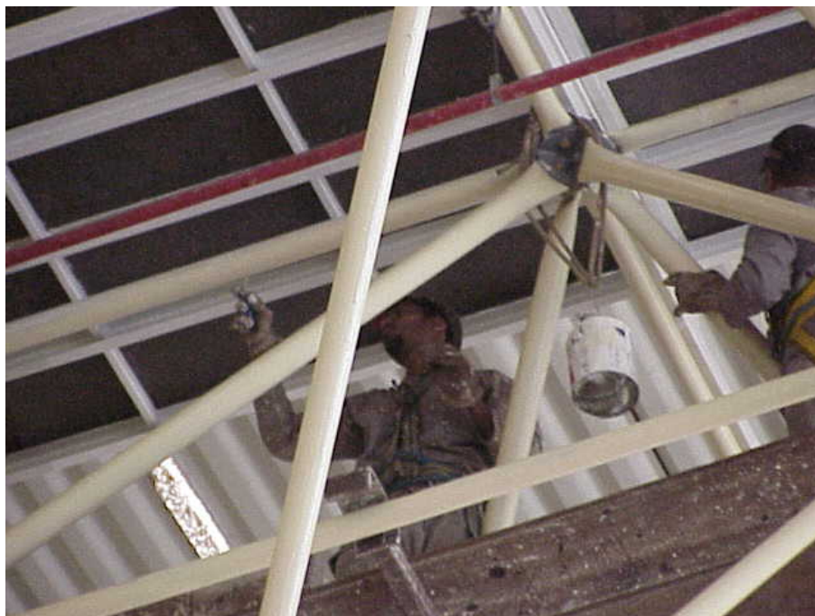
Foto 4 – Veja a calha do telhado com o acabamento final, branco neve, e as barras com o primer na cor creme
