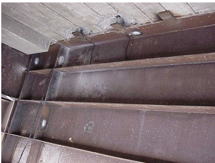
Foto 5 - Vista interna de uma das vigas da ponte. Detalhe dos sensores instalados nos enrriquecedores e na mesa superior, próximo ao apoio
