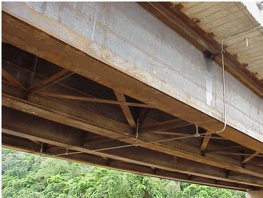
Foto 3 - Detalhe das 4 vigas principais. Os sensores instalados com seus cabos devidamente acondicionados em tubos de aço galvanizado
