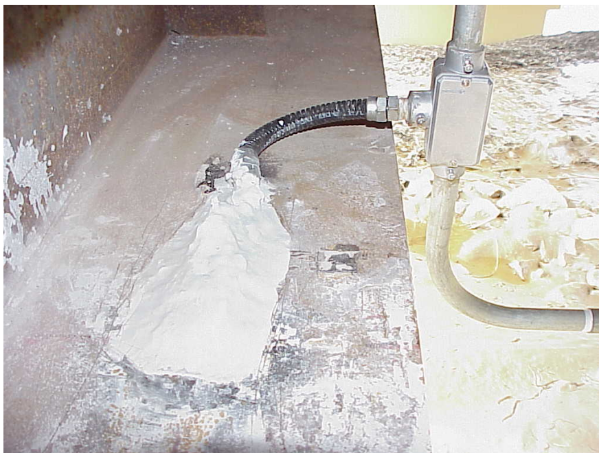
Foto 4 - Detalhe do sensor após a sua proteção e acondicionamento dos cabos
