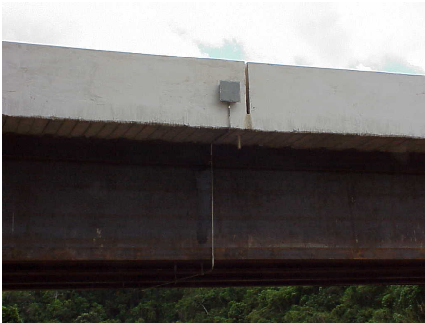
Foto 08 - Detalhe da caixa de alumínio que acondiciona os terminais dos cabos do sistema de aquisição de dados
