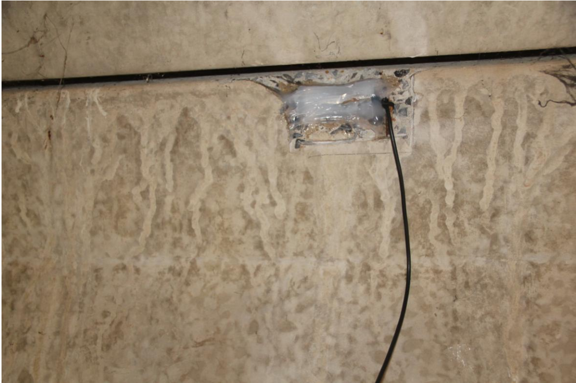
Foto 5 – Sensor instalado e protegido
