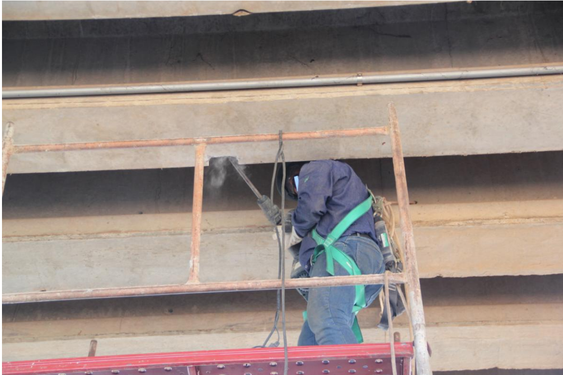
Foto 3 – Funcionário da AJL retirando o cobrimento da viga para alcançar a armadura
