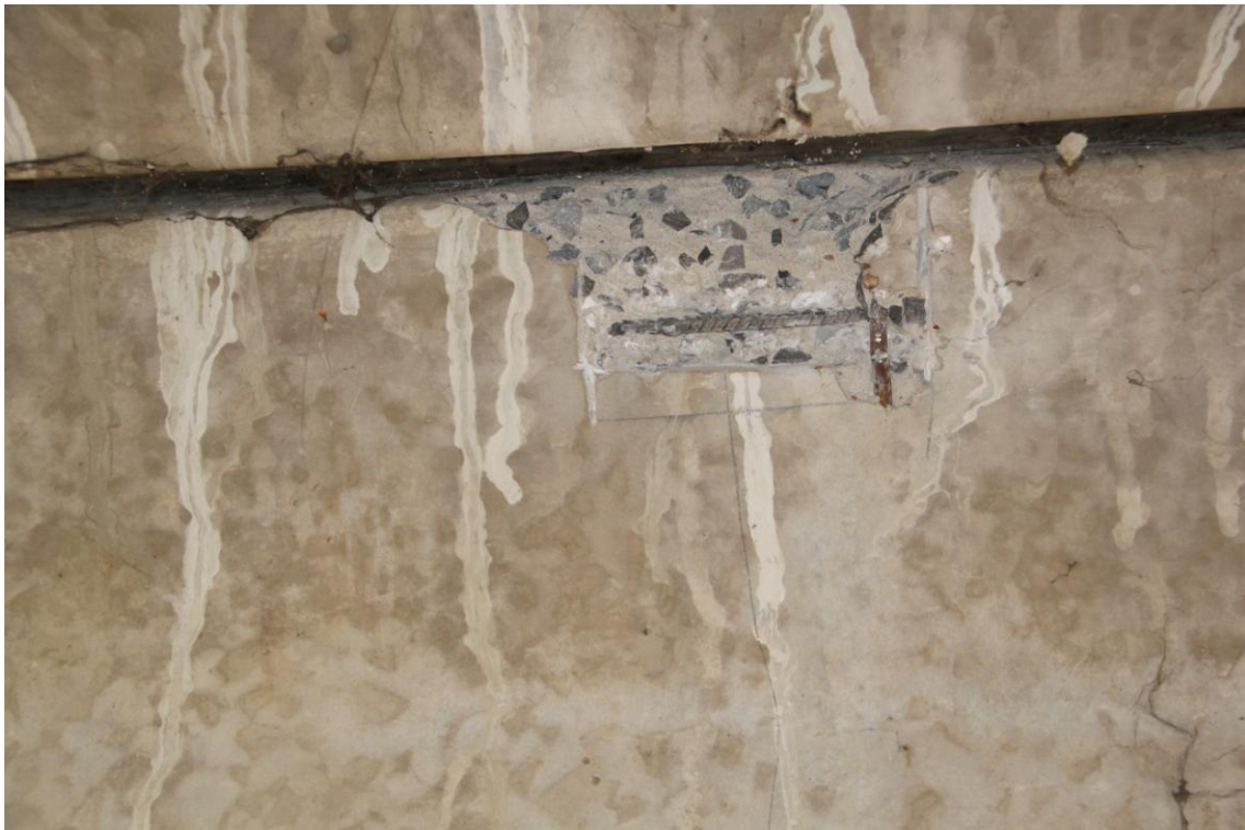
Foto 4 – Armadura exposta, faltando lixar e limpar para colar o sensor
