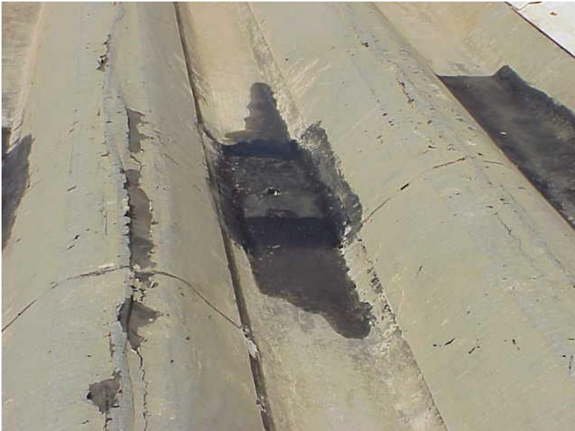
Foto 4 - Detalhe das fissuras na cobertura
