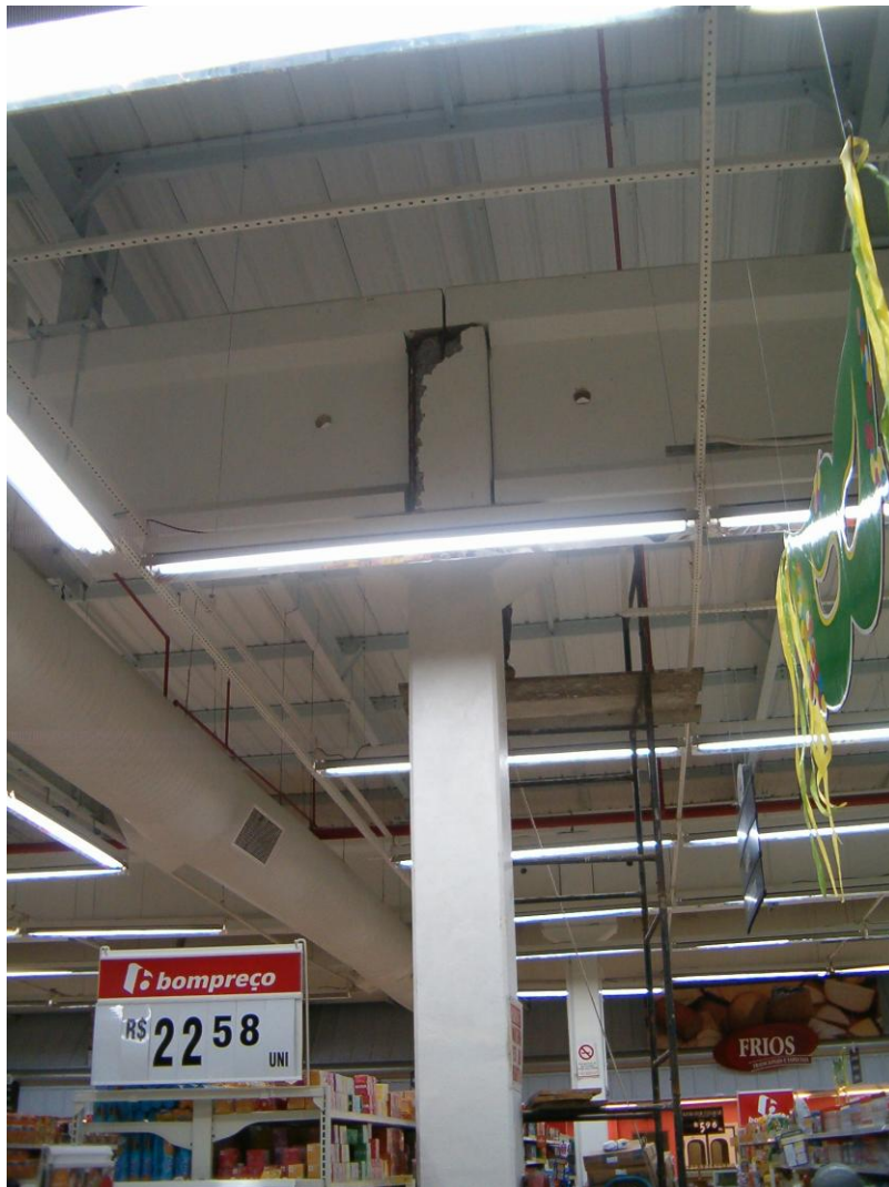
Foto 6 – Topo do pilar com a armadura exposta
