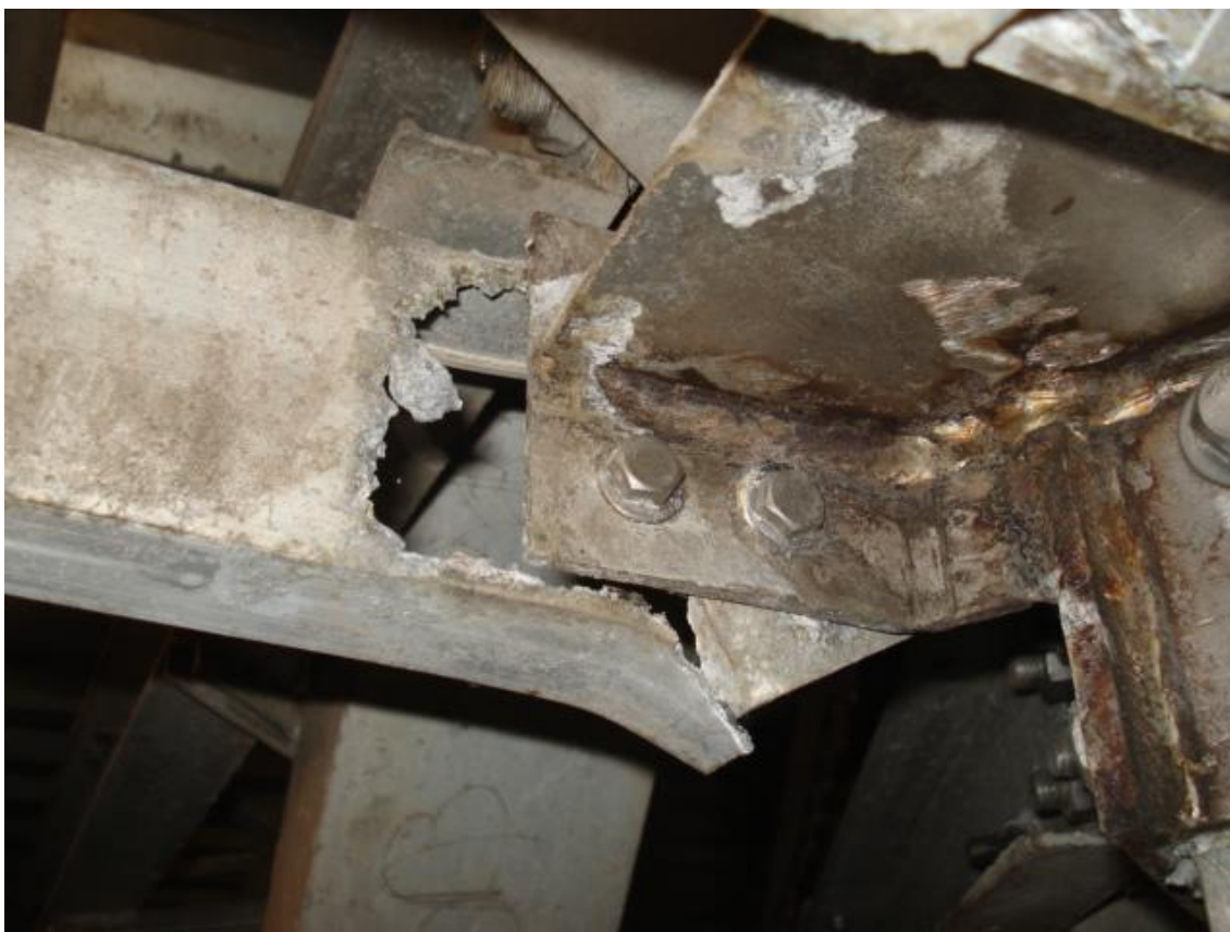
Foto 1 – Detalhe da corrosão nos nós da cobertura do Hiper Bompreço Armação
