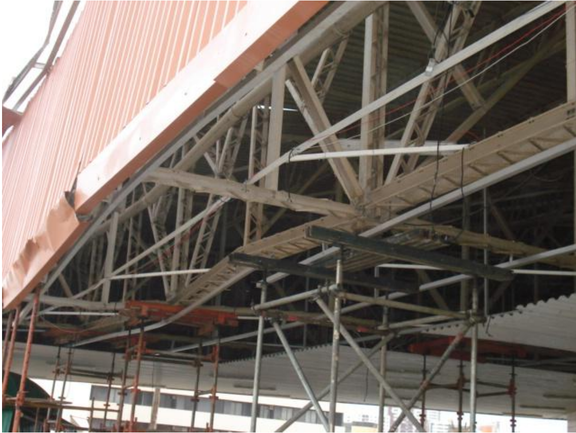
Foto 8 – Escoramento da cobertura (Detalhe da situação crítica na entrada da Loja)
